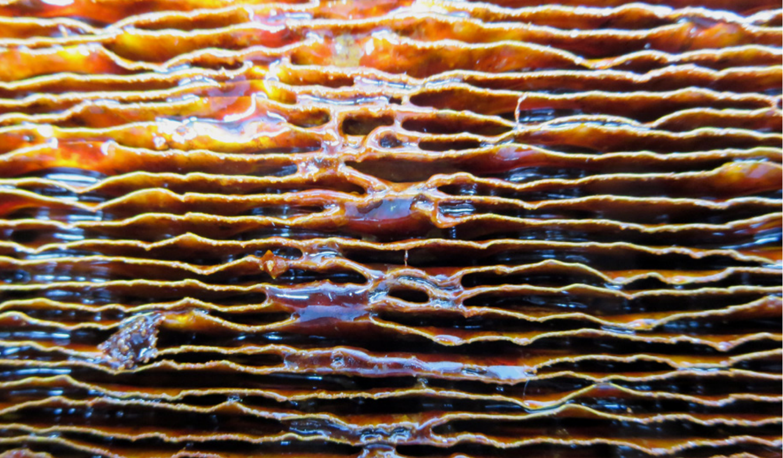
Beim Trocknen des Vormaterials – ehemalige PET-Flaschen – verlegen harzähnliche Verunreinigungen die Kühlregister. Sie mussten bisher in unangenehmer und zeitraubender Handarbeit gereinigt werden. Bild: MAP PAMMINGER GmbH
