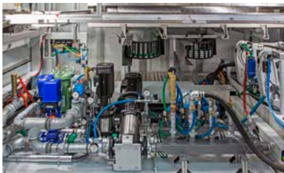
Zwei Pumpen und Mischventile versorgen zwei getrennte Kühlkreisläufe für das Ober- und Unterwerkzeug. Bild: Kiefel
